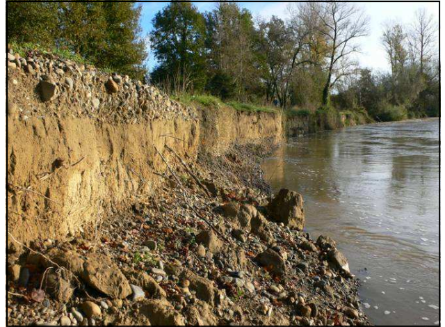
Erosion de berge au sein de l'espace de mobilité. (Source Institution Adour)
